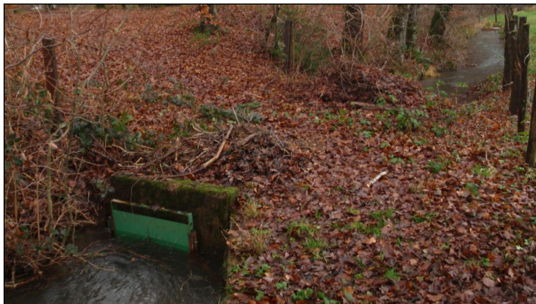
Vanne de prise d'eau du canal du moulin d'Eloie
